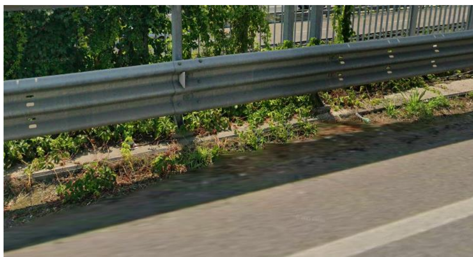
Figura 5: Presenza di vegetazione che occulta le zanelle
