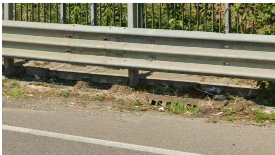
Figura 4: Ostruzione canalette di raccolta
