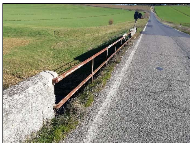
Foto 6 Stato di fatto barriera di sicurezza laterale su corsia dir. Cesa
