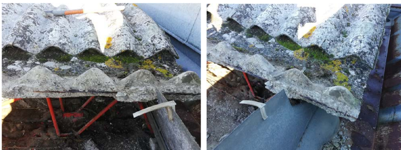
Foto dello stato di degrado del copriferro in alcuni punti delle travi c.a.p. di copertura
