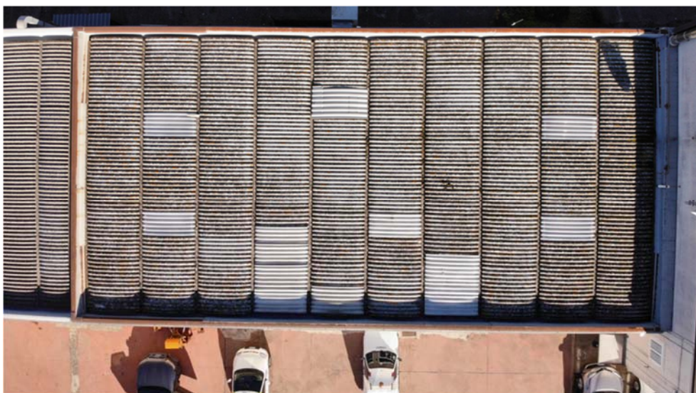
Foto dall'alto della copertura di 220,50 mq in lastre ondulate curve contenente amianto
