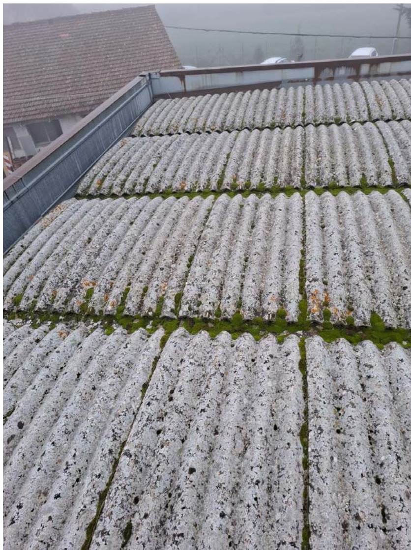
FOTO dei canali superiori delle travi completamente ostruite da materiale organico
