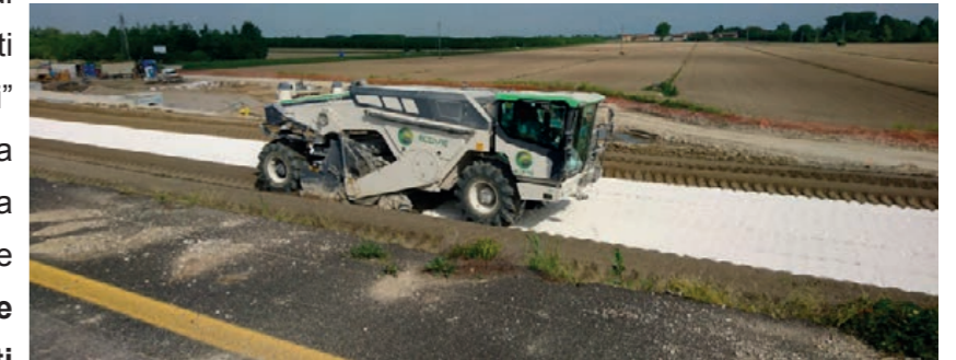
La stabilizzazione a calce del sottofondo limo-argilloso permette l'utilizzo di materiale in sito minimizzando l'apporto da cava ed il trasporto a discarica con i conseguenti oneri di discarica
