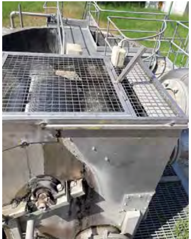
Impianto di depurazione La Nave Bibbiena Sostituzione del carter di protezione del rotostaccio
