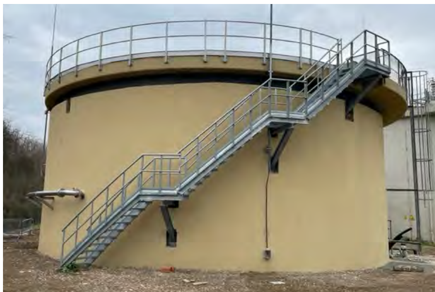
Figura 30: Revamping impianto di depurazione Casolino, Arezzo. Lavori lotto 1 - Rinnovo digestore anaerobico secondario
