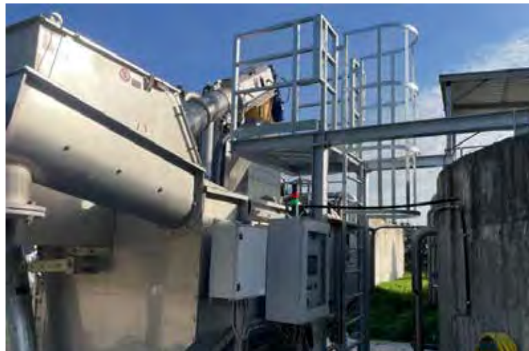
Impianto di depurazione La Colmata (Monte San Savino) Adeguamento macchinario trattamento extraflussi
